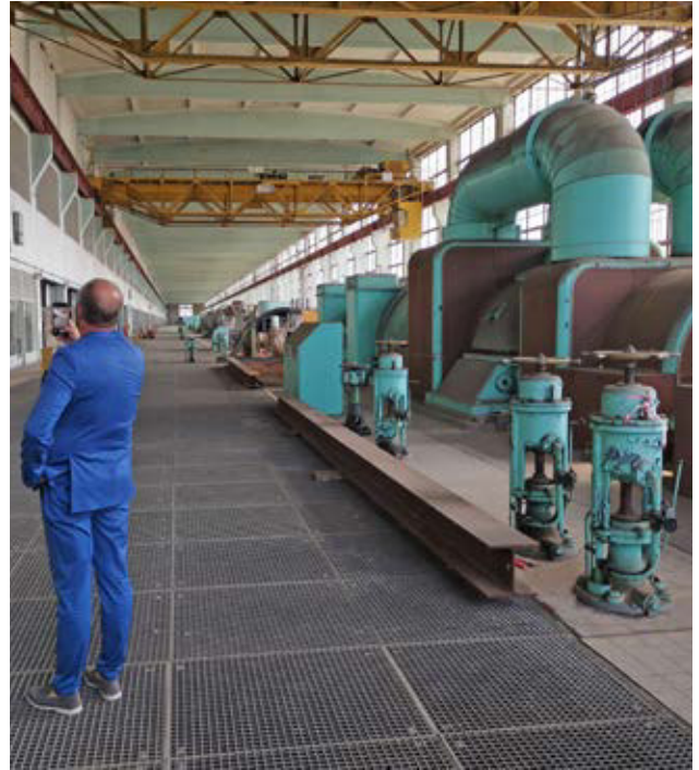
Innenansicht Kraftwerk Frimmersdorf © Zweckverband LANDFOLGE
