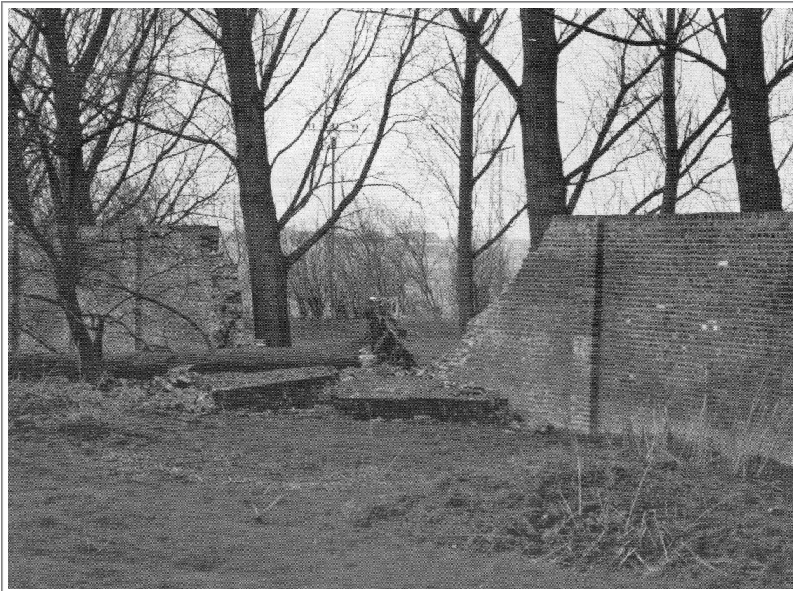
Foto 16: Durch Orkan Wiebke beschädigte Umfassungsmauer im März 1990
